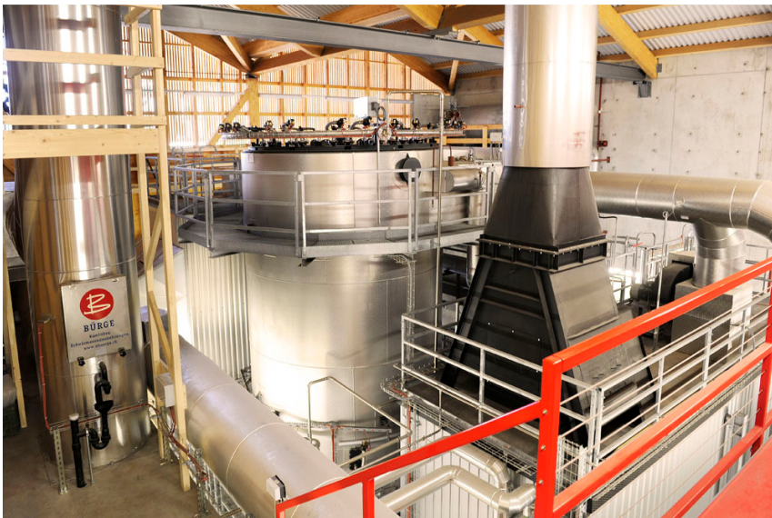
Feuerungsanlage mit Thermoölerhitzer, Kamin und Notkamin:
